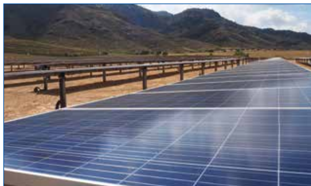
Instalación FV de la CCRR “Miraflores” Jumilla
