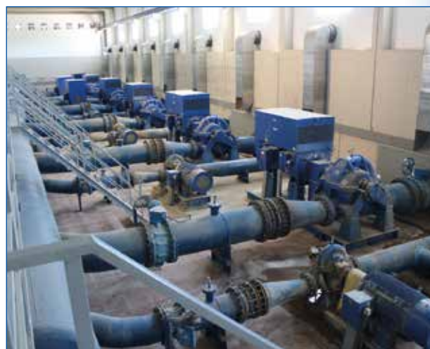
Estación de bombeo La Catalineta, CCRR Genil Cabra
