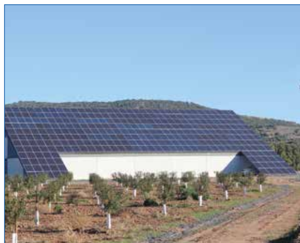
Instalación fotovoltaica en aislada para riego de almendro
