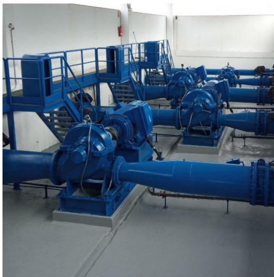
Figura 31. Estación de bombeo sector VIII. Fuente: C.R. Valle Inferior del Guadalquivir.
