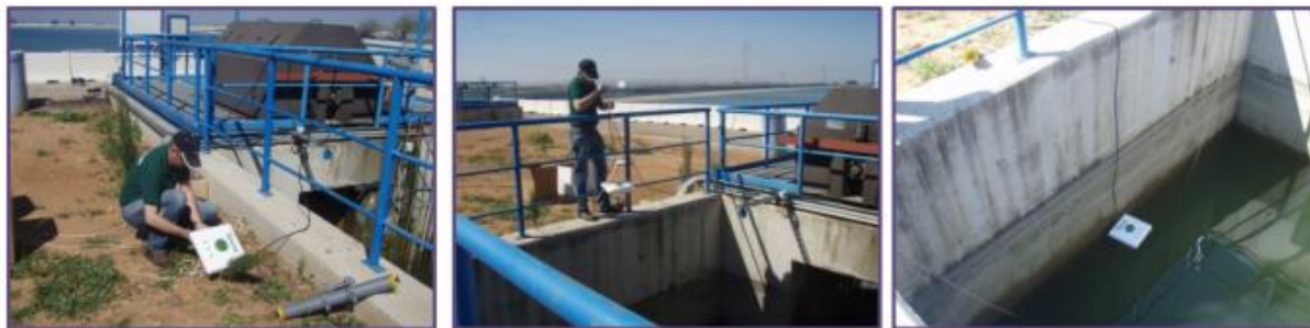
Figura 49. Instalación del equipo DUMO algacleaner ACM-150 en la arqueta de filtrado del Sector IX. Fuente: C.R. Valle Inferior del Guadalquivir.
