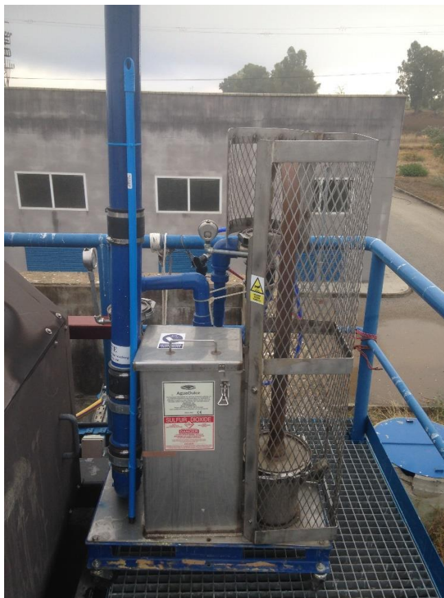
Figura 70. Equipo quemador de azufre AguaDulce Ibérica en la arqueta de filtrado de la estación de bombeo del sector II de la Comunidad de Regantes del Valle Inferior del Guadalquivir. Fuente: C.R. Valle Inferior del Guadalquivir.
