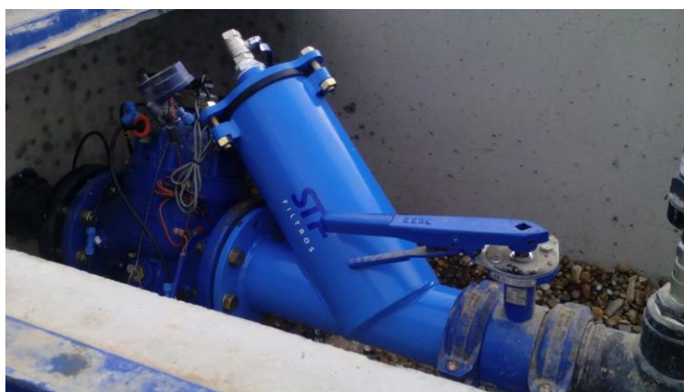
Figura 60. Instalación de filtro ciclónico STF FYCIC Tipo B. Fuente: C.R. Valle Inferior del Guadalquivir.
