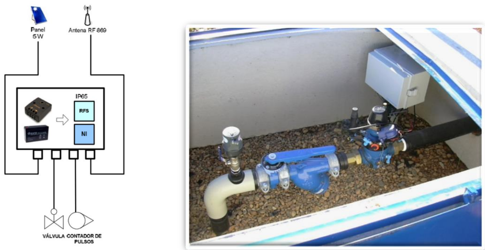
Figura 36. Instalación de sistema de telecontrol en hidrante tipo. Fuente: C.R. Valle Inferior del Guadalquivir.
