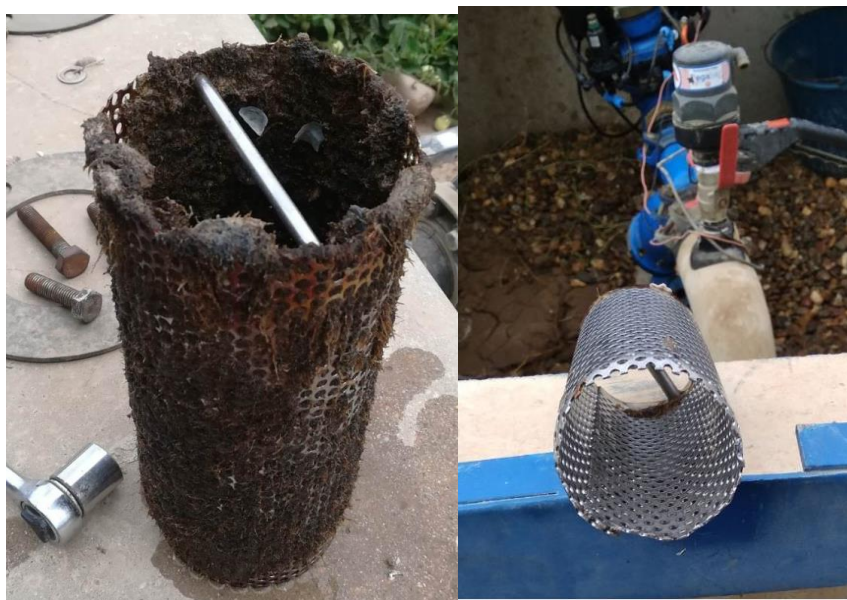
Figura 63. Filtro cazapiedras antes (izquierda) y después (derecha) de la generación de sobrevelocidades. Fuente: C.R. Valle Inferior del Guadalquivir.
