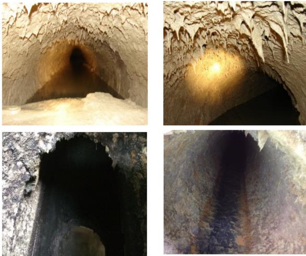
Figura 53. Interior de la tubería afectada por la plaga de briozoos en el Sector 6 de la CRVIG antes del tratamiento ultrasónico (arriba) y después del tratamiento (abajo). Fuente: Toscano Línea Electrónica, S.L.
