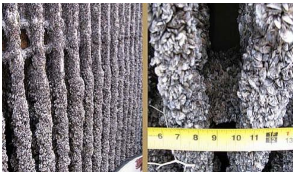
Figura 48. Obturación de rejillas y obras de toma. Fuente: Endesa.
