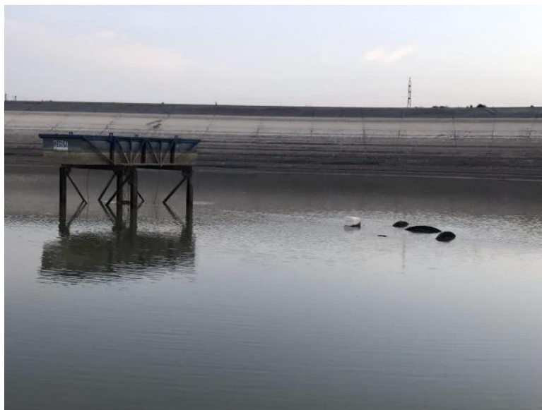
Figura 58. Vaciado de balsa donde se aprecia la colonización por mejillón cebra y briozoos en la lámina impermeabilizante. Fuente: C.R. Valle Inferior del Guadalquivir.
