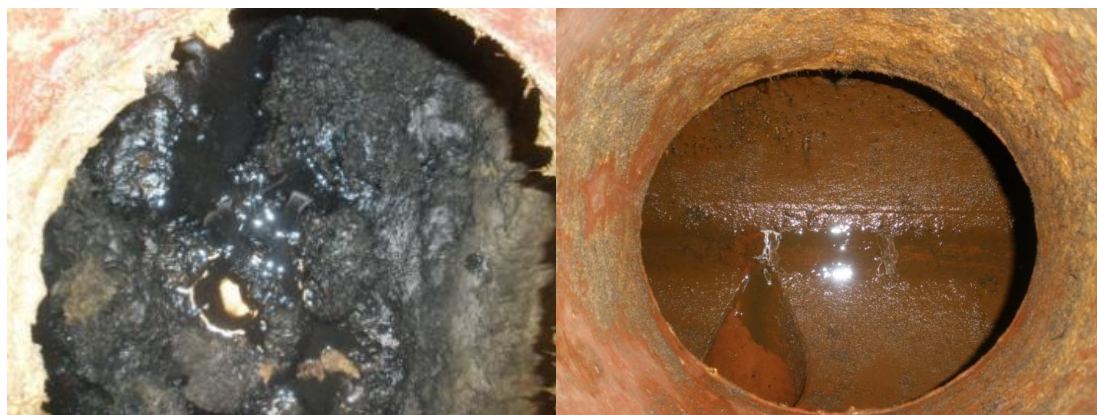
Figura 65. Estado del interior de la tubería antes de las operaciones de sobrevelocidades (izquierda) y después (derecha). Fuente: C.R. Valle Inferior del Guadalquivir.
