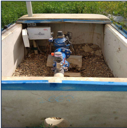
Tomas de riego individuales con caudalímetros
