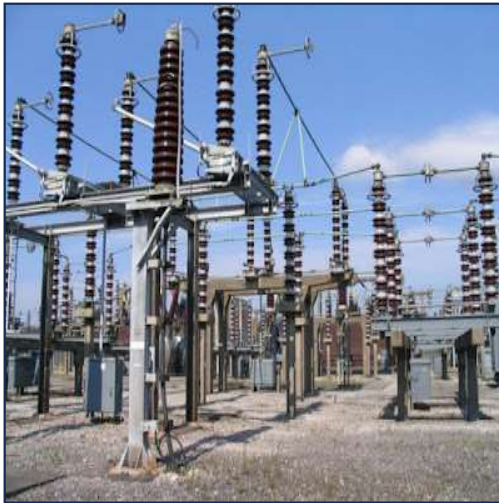
Subestación y Línea Eléctrica
