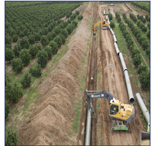
Red de 500 km de tuberías
