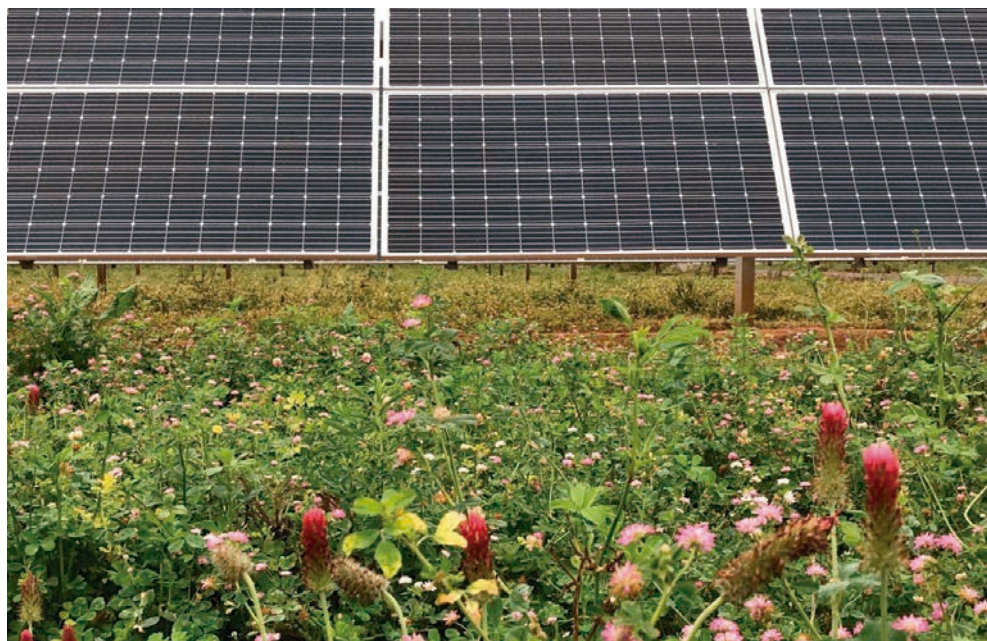
Cubierta vegetal en el parque solar.
