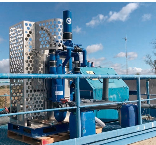
Máquina ácido sulfuroso en estación de bombeo.
