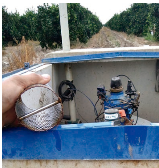
Cartucho filtro cazapiedras en hidrante.
