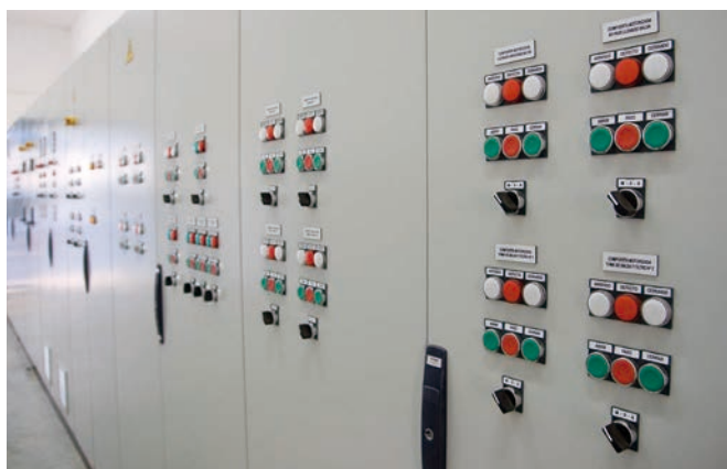
Sala cuadros estación de bombeo.
