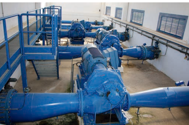
Foso bombas de una estación de bombeo.
