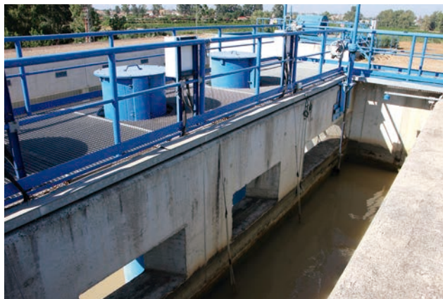
Arqueta de llenado de balsa.
